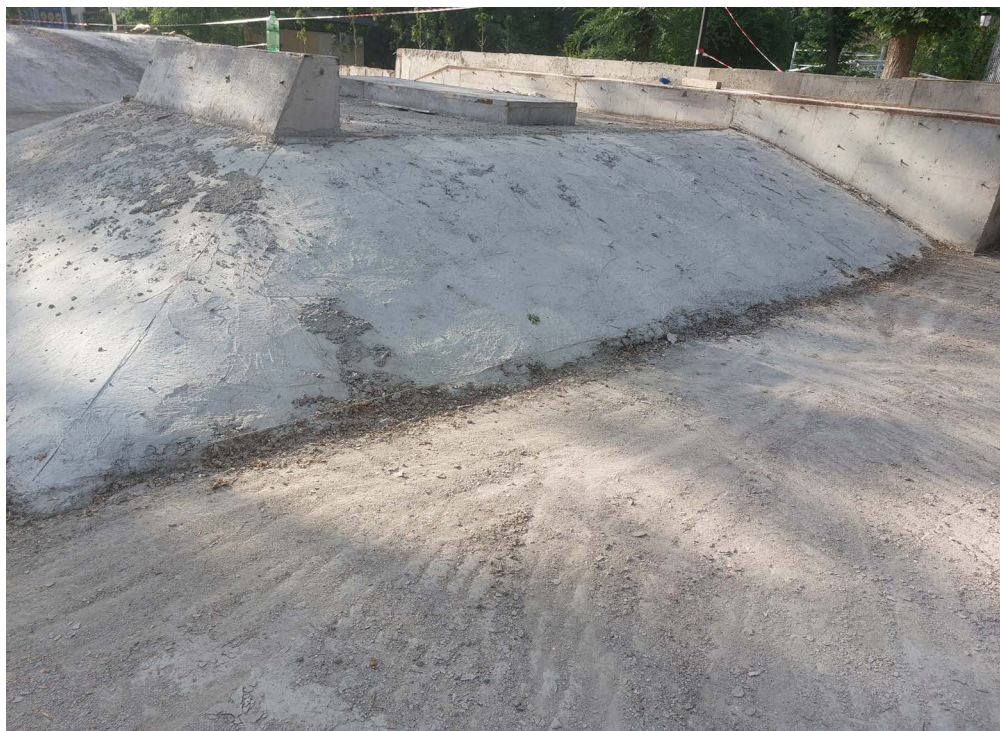
Фотография иллюстрирует нарушение технологии строительства бетонного скейт-парка
